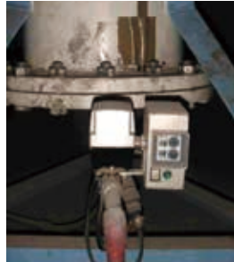
大型空气过滤器 水泥 2001年 ~
