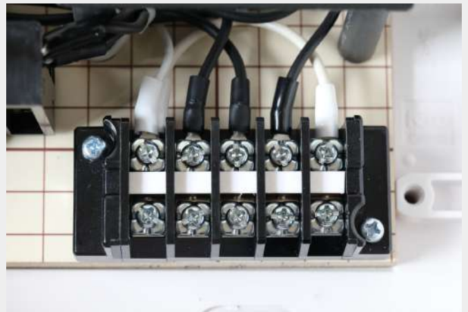
便於連接控制閥門等的接線盤
